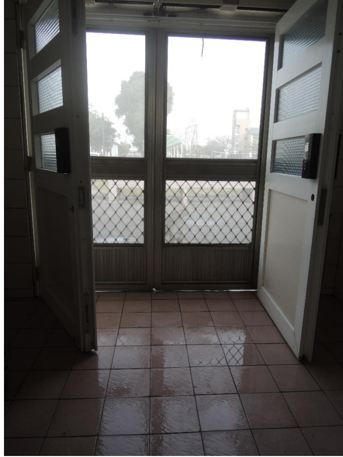
裝設紗窗、紗門，設有病媒防治措施。
